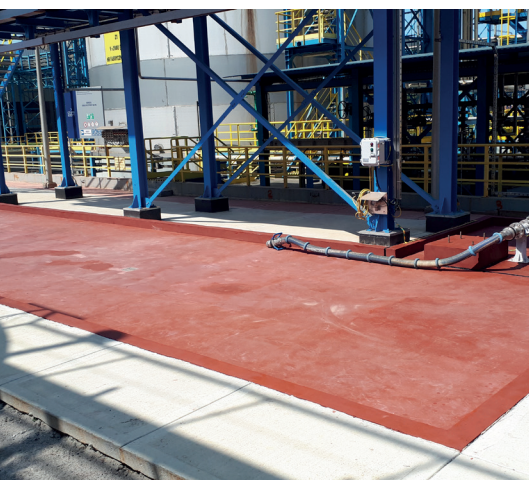
Zabezpieczenie tacy stokażu kwasu azotowego
