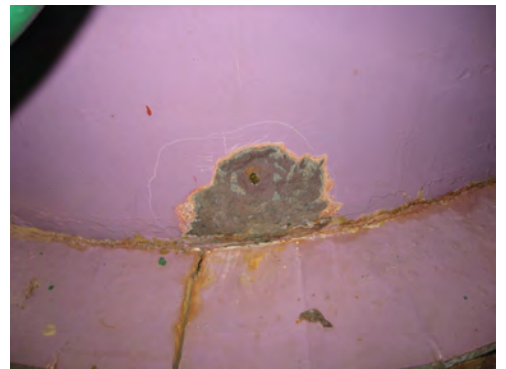
Widok uszkodzenia powierzchni zbiornika
