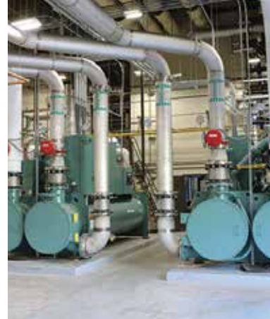
Fot.1. Zespół wymienników chillerów systemu HVAC
