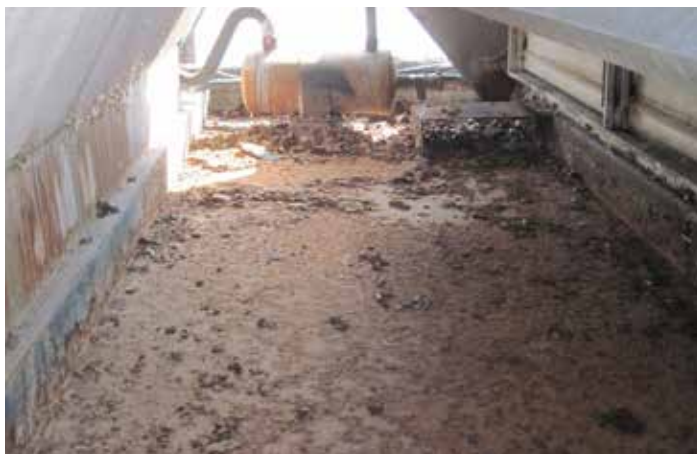
Fot.4a. Korozja wanny ociekowej wieży chłodniczej układu HVAC
