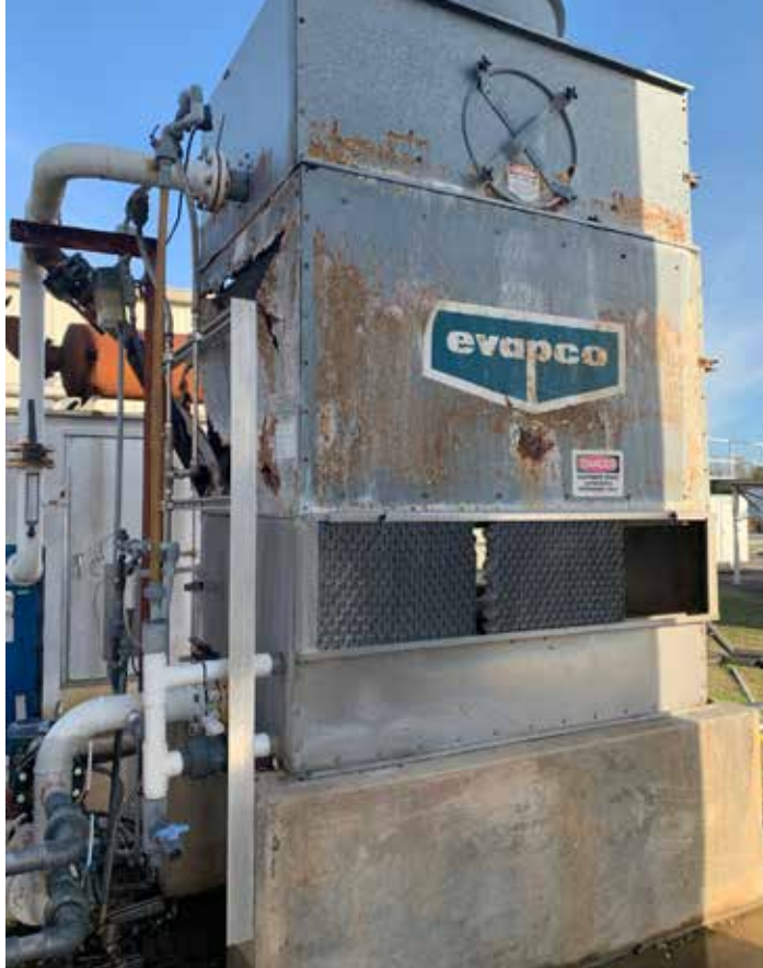
Fot.3a. Wieża chłodnicza z korozją blach poszycia
