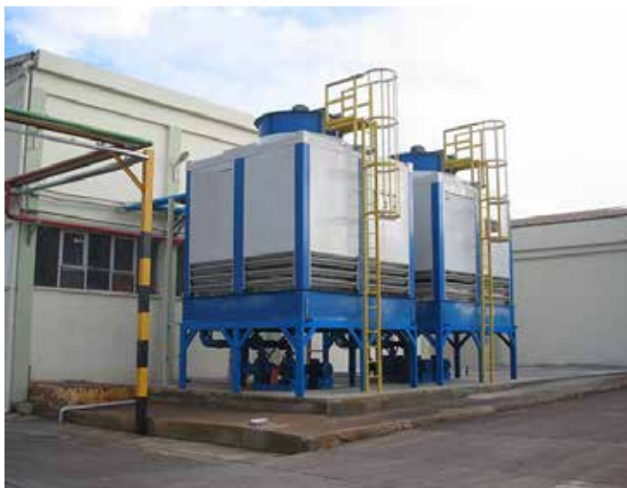
Fot.3b. Wieża chłodnicza układu HVAC
