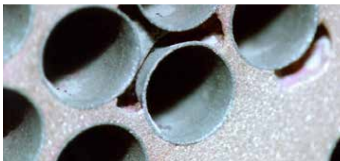
Fot.2b Korozja elektrochemiczna -wżery korozyjne w styku rurka-dno sitowe
