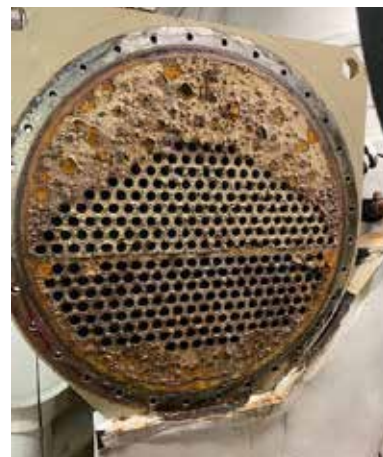
Fot.2a. Korozja dna sitowego wymiennika ciepła chillera
