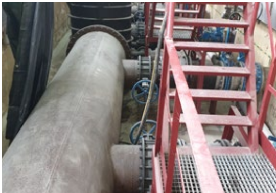
Fot.1. Kolektor (rurociąg) tłoczny osadu
